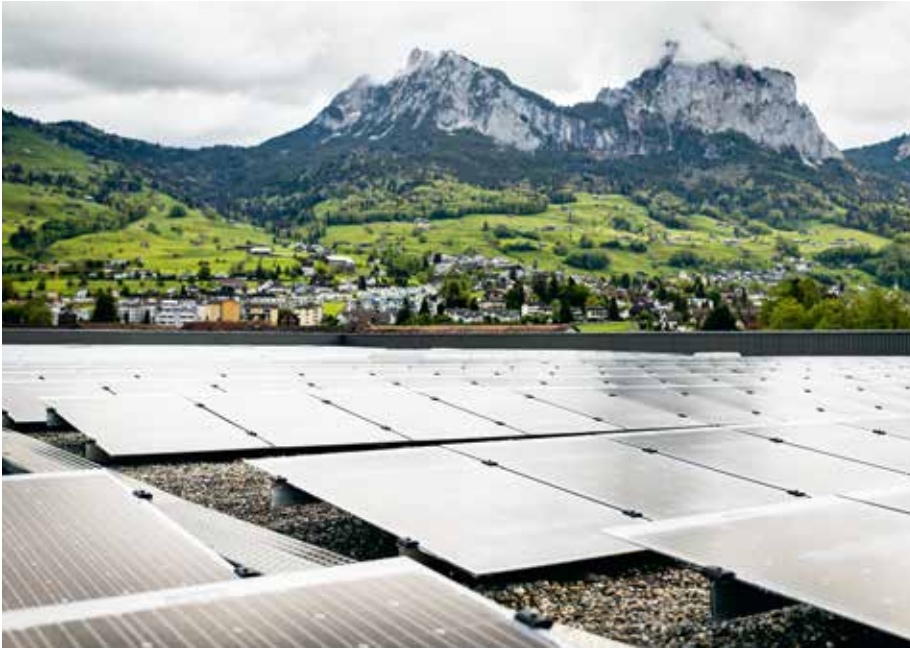
Die Fotovoltaikanlage produziert mehr Strom, als Victorinox benötigt.
