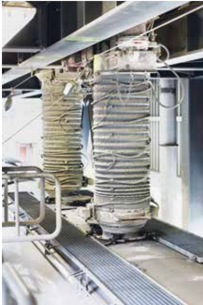
Installation de remplissage pour le transport ferroviaire
