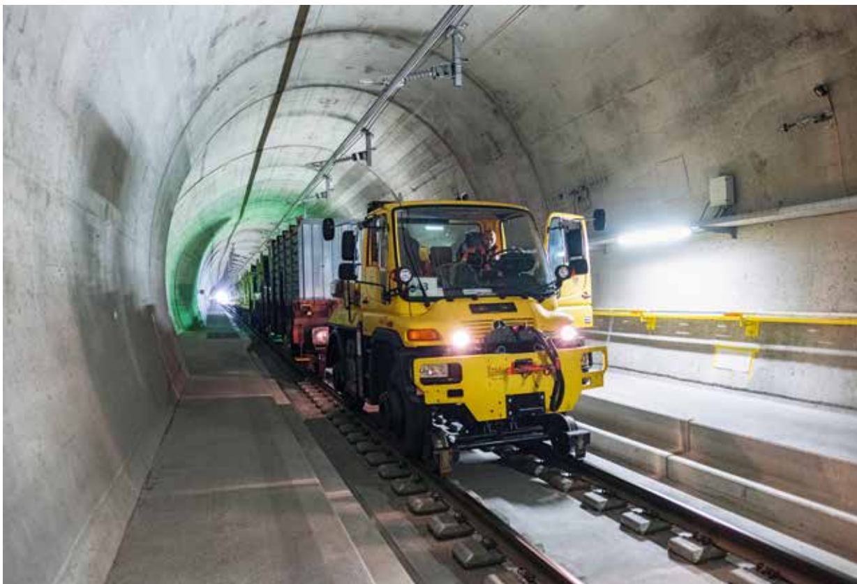
Les mains courantes jaunes sur la paroi du tunnel s'éclairent en cas d'événement.
