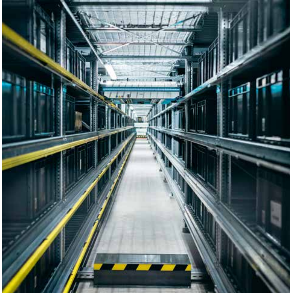
Il magazzino per minuteria è completamente automatizzato.
