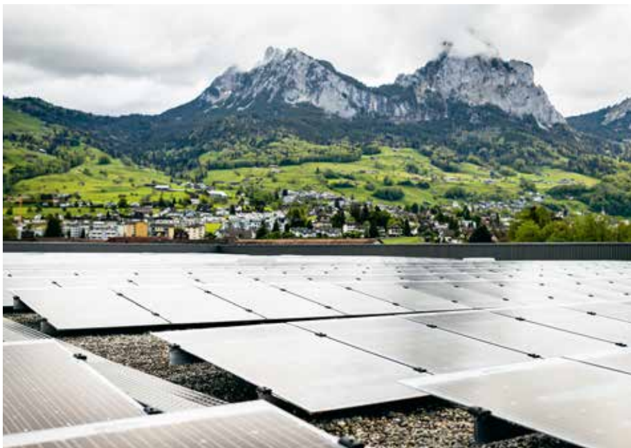
L'impianto fotovoltaico produce più corrente di quanta ne serva all'azienda.
