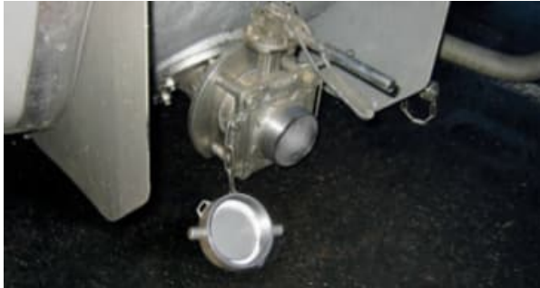
Nicht aufgesetzter Blindflansch
