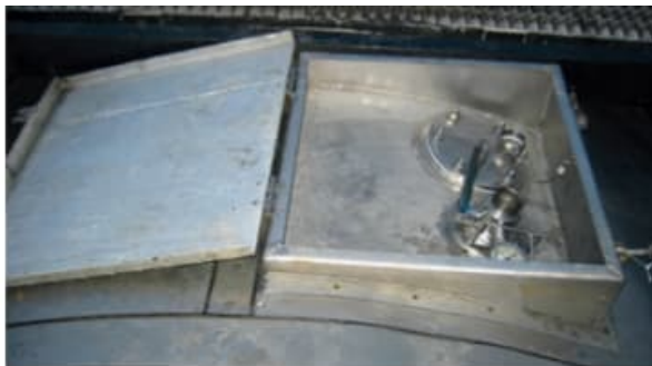
Nicht verschlossene Schutzabdeckung für Armaturen
