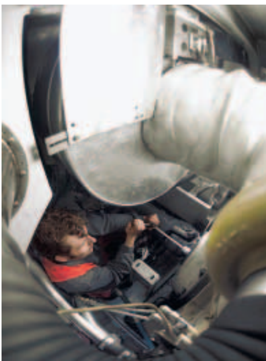
Filtre à particules fines de deux mètres cube.
